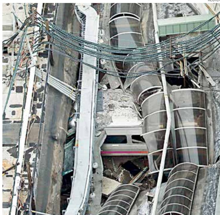
LA TRAGEDIA. El impacto del tren provocó el derrumbe del techo de la estación.
